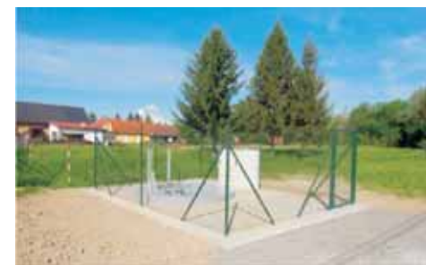
Čerpací stanice ČS1 – čerpací systém EMUPOURT WILO
