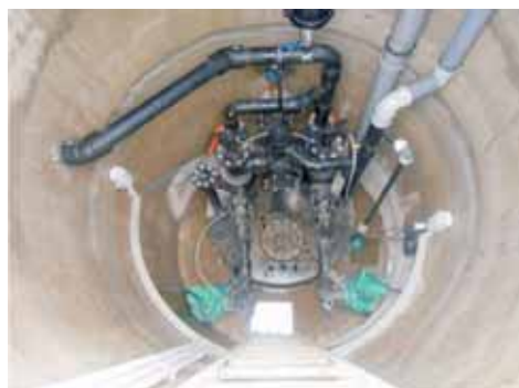
Čerpací stanice ČS1 – čerpací systém EMUPORT WILO
